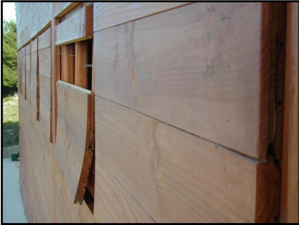
Foto 16: Estado de las ventanas antes de los trabajos.
