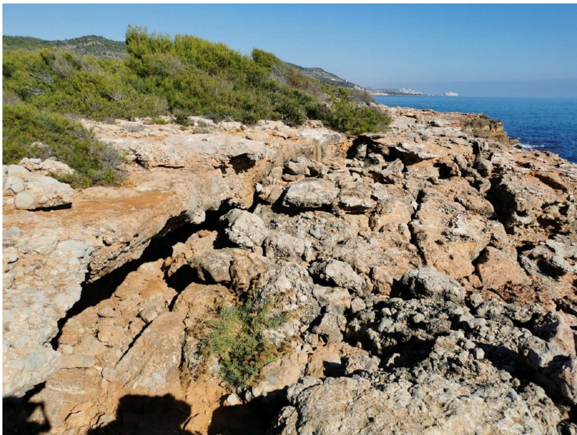
Foto 2. Hundimiento y pérdida de suelo
