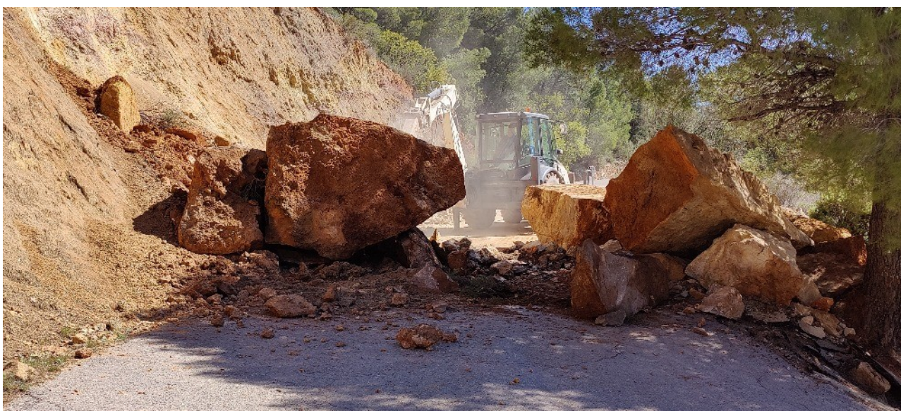
Figura 1.- Ruptura i retirada de blocs després del lliscament de terres que el 30/03/22 va tallar el camí de Canaig (carrer de La Pobleta, Serra). Foto: Jaume Signes.
