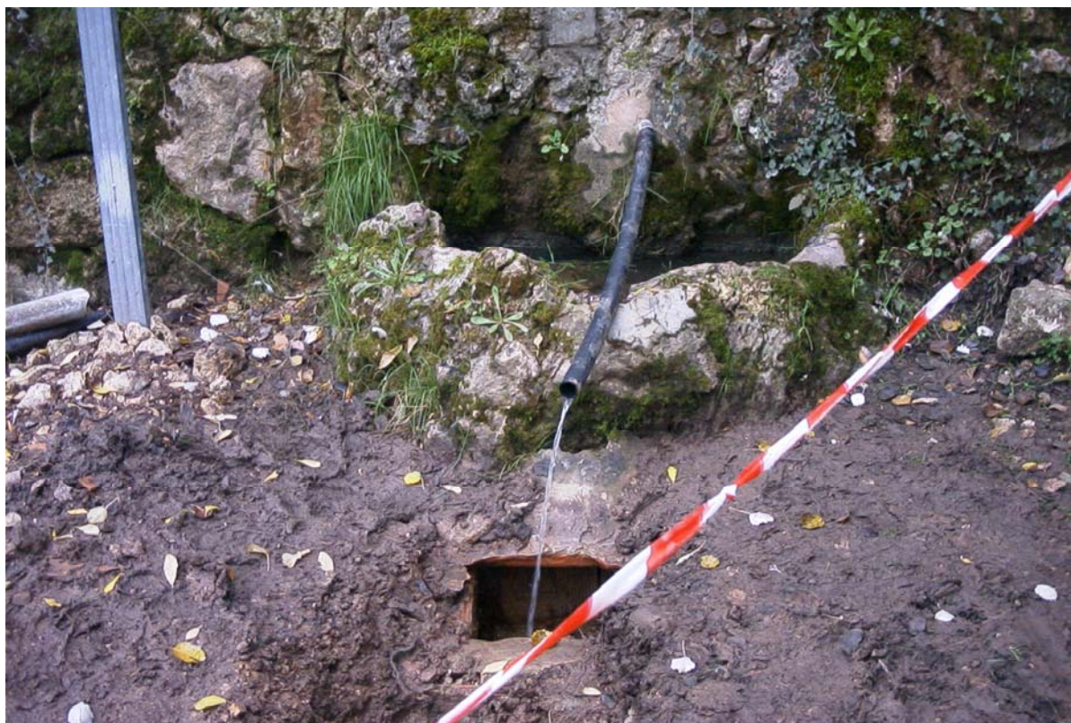
Reparación de la tubería que daba salida al sobrante de agua de la Font dels Xops.
