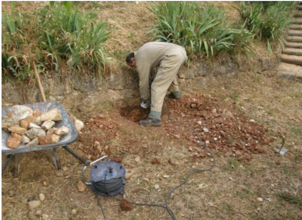
Treballs d'instal·lació de la senyal de l'àrea d'acampada. Font: Parc Natural de la Font Roja.
