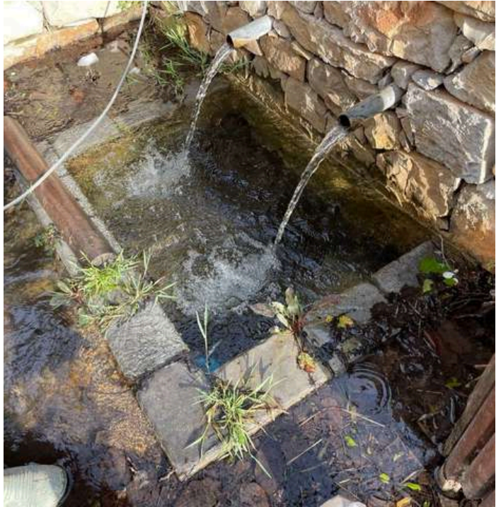
Fuelle del Ramblizo obstruida (Sot de Chera)
